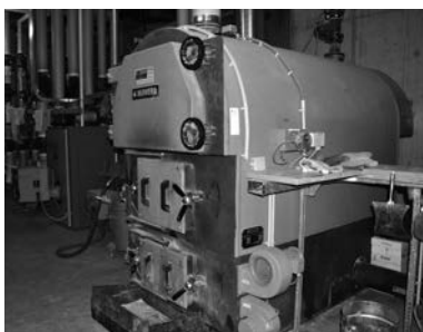
Biomasseheizung des Frödischsaals
