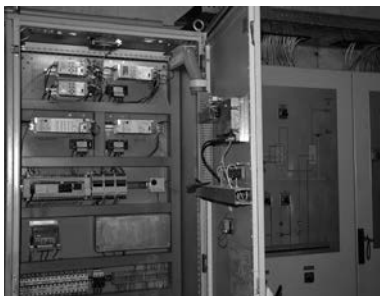
Uralter Schaltkasten im Technikraum des Frödischsaals
